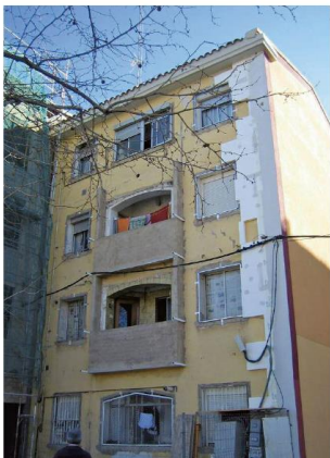
Fotografía: J. Rubio (Gera Mayra, 4-6, Grupo Pizarra, Zaragoza) Proyecto de rehabilitación: Olano, Mendo y S. Marín, Arquitectos
