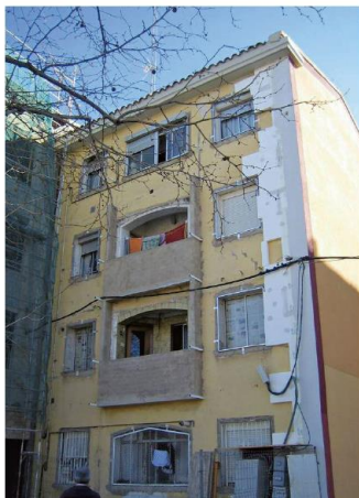
Fotografía: J. Rubio (Sara Maynar, 4-6, Grupo Pizarra, Zaragoza) Proyecto de rehabilitación: Clero, Mendo y S. Marta, Arquitectos
